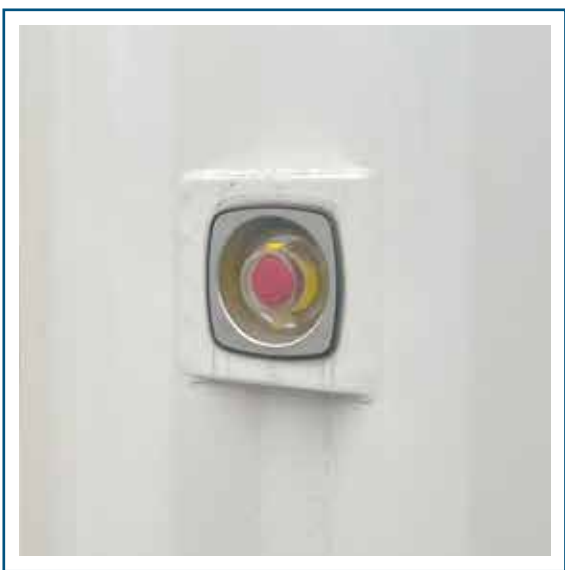
Parada de emergencia externa
