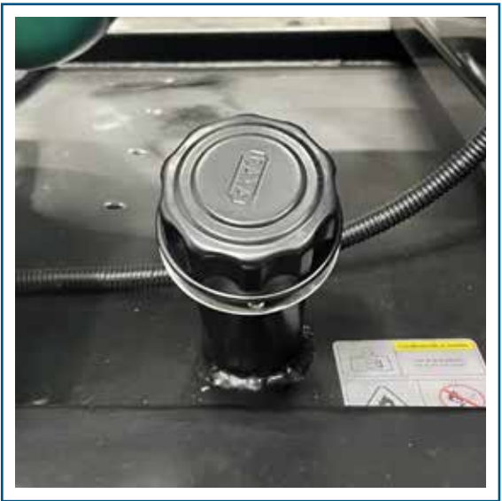
Carga de combustible
