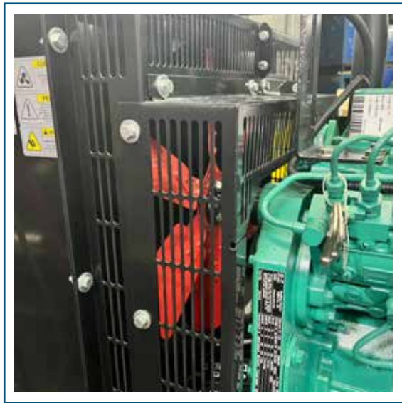
Refrigeración por agua
