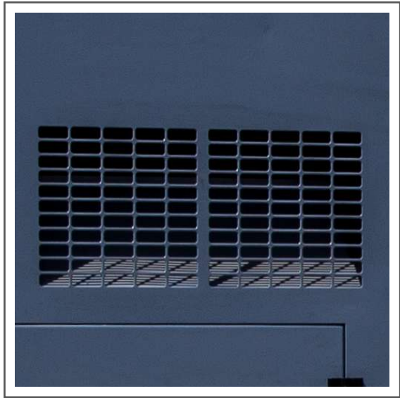
Ductos de ventilación
