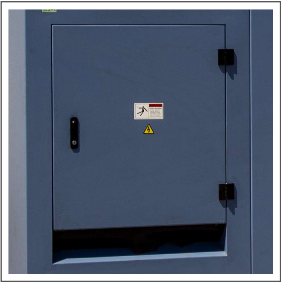
Bornera de conexión
