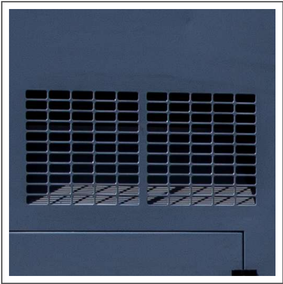
Ductos de ventilación
