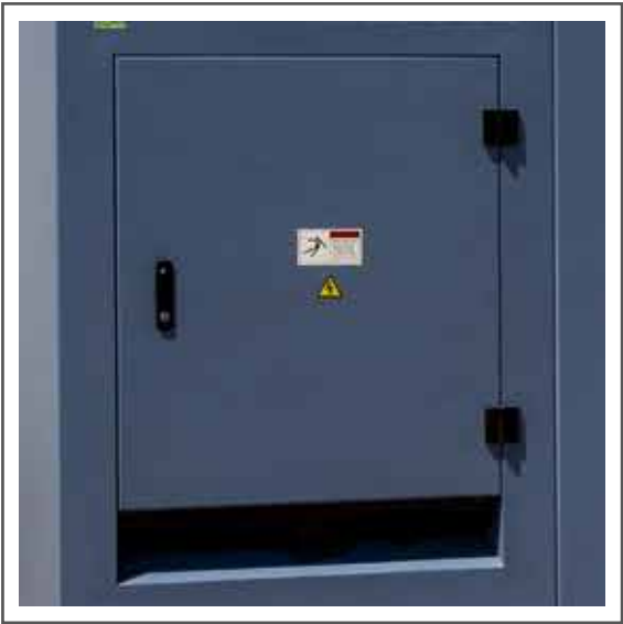
Bornera de conexión
