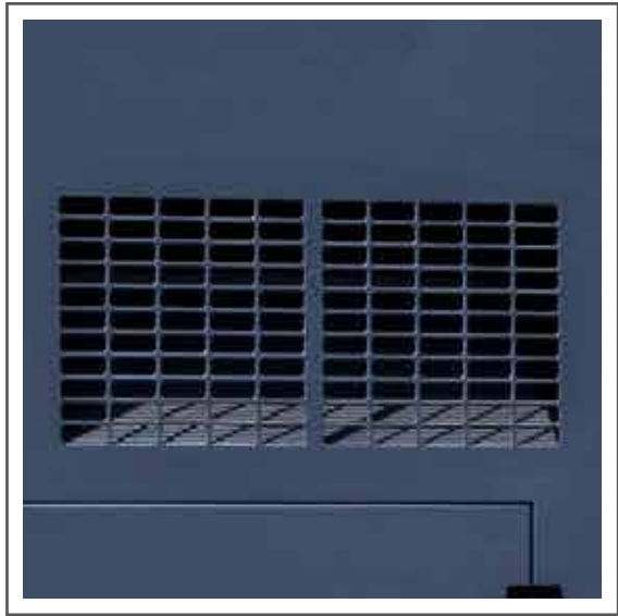
Ductos de ventilación
