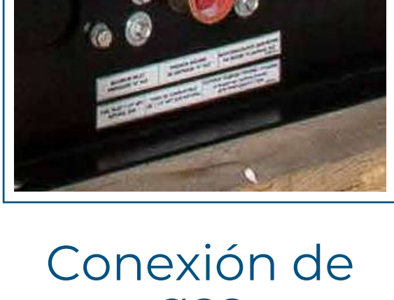
Conexión de gas
